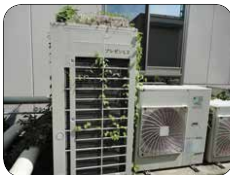
草で覆われた室外機
