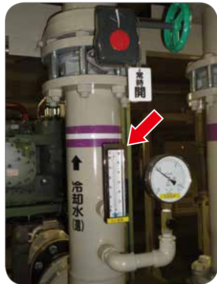
冷却水出口温度計確認
