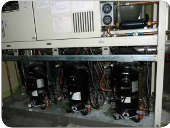
ユニット型冷凍機の異常振動確認
