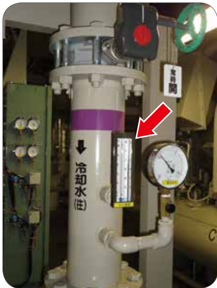
冷却水入口温度計確認
