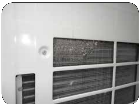
室外機に付着したゴミ
