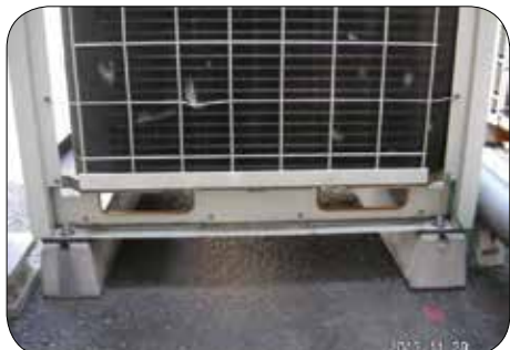
室外機のキズ
