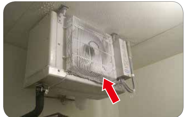
冷却器の内部霜付き異常
