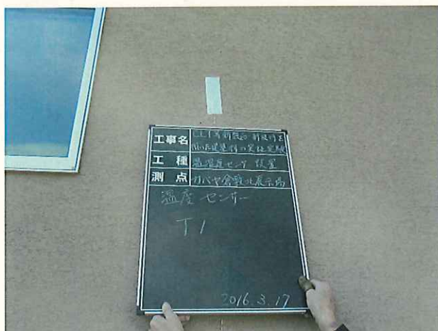
写真-46 温度センサー設置状況
