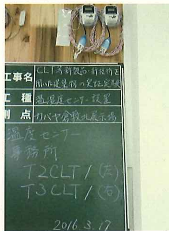
写真-37 データロガー設置状況
