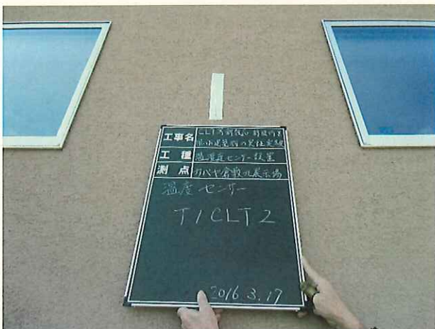
写真-40 温度センサー設置状況
