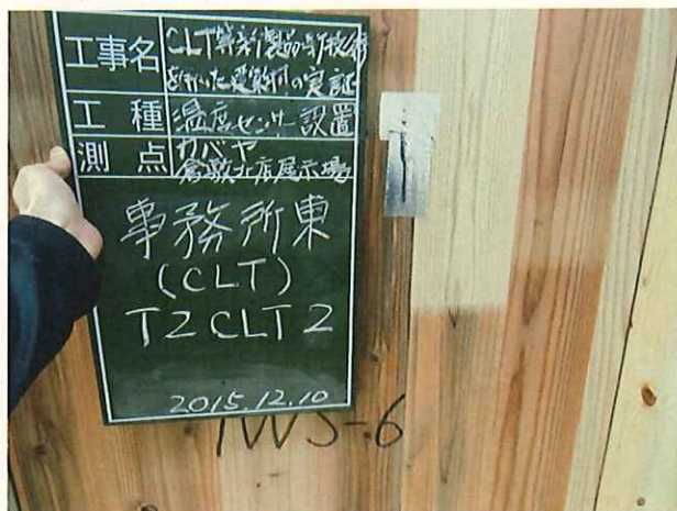
写真-42 温度センサー設置状況
