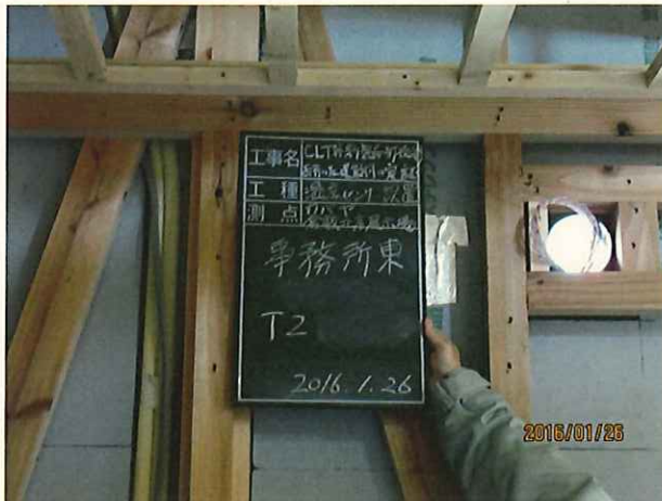
写真-48 温度センサー設置状況
