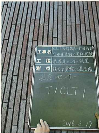
写真-34 温度センサー設置状況
