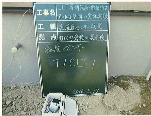
写真-35 データロガー設置状況
