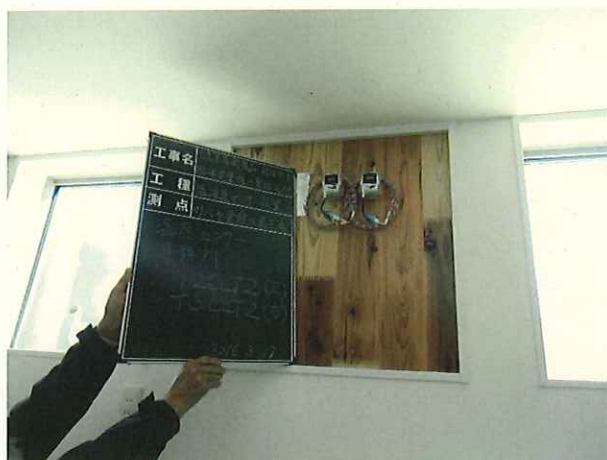
写真-43 データロガー設置状況
