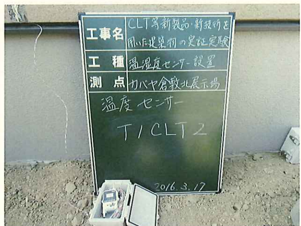
写真-41 データロガー設置状況
