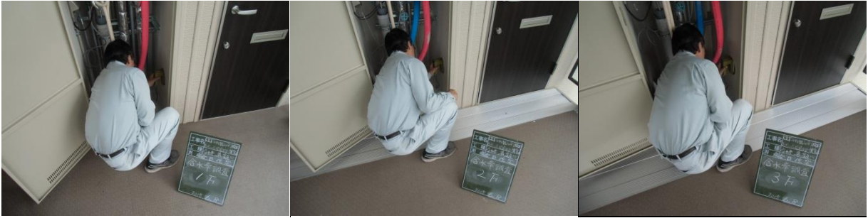
写真一六 含水率調査状況（平成27年6月8日）
