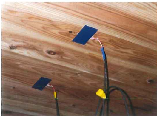
写真 2.4 天井センサ設置状況
