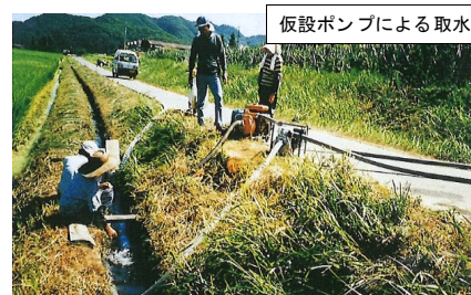
仮設ポンプによる取水
