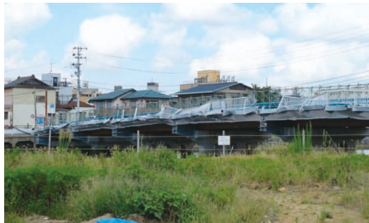
図2 欄干が破損した橋梁
