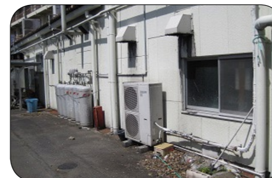
室外環境異常による配管の劣化
