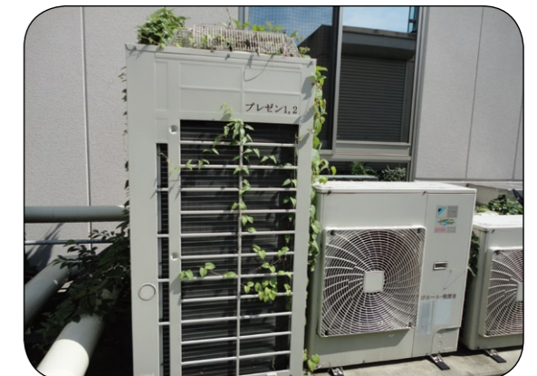
草で覆われた室外機
