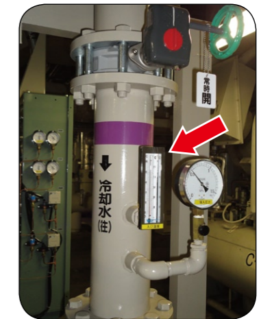
写真-E 冷却水入口温度
