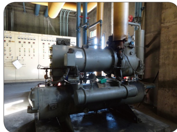
冷凍機異常振動・異常運転音 異常発停止、各圧力・電流・電圧記録
