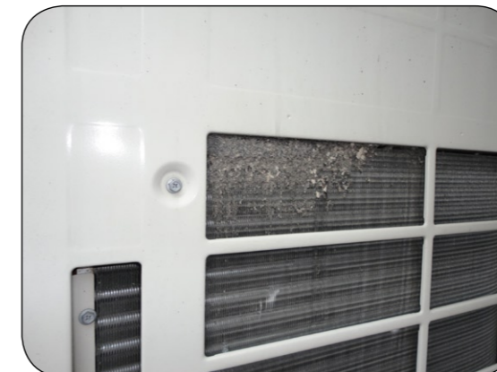
室外機に付着したゴミ
