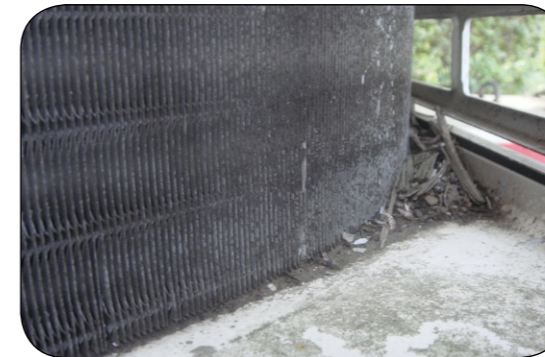
熱交換器下部の腐食
