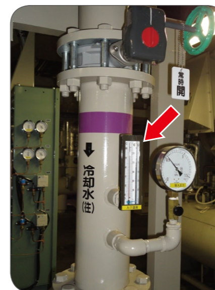
冷却水入口温度計確認
