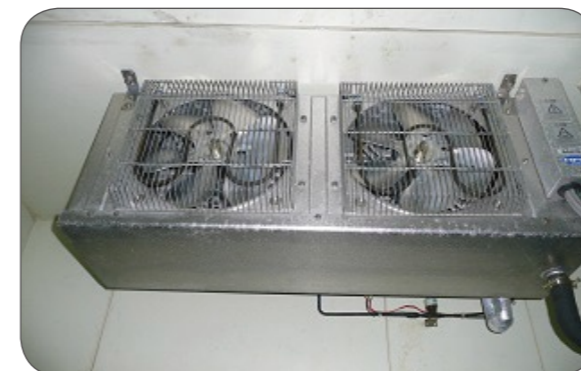
冷蔵庫内正常な冷却器外観
