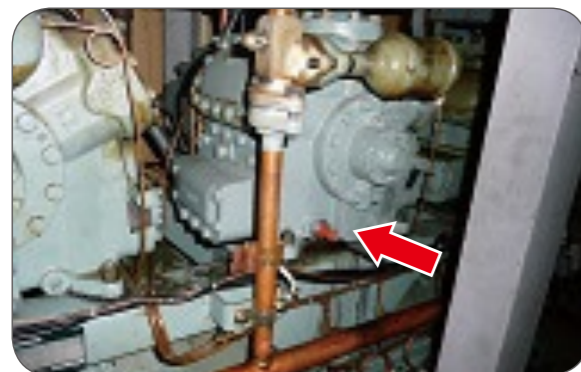
圧縮機周辺の油のにじみ状況
