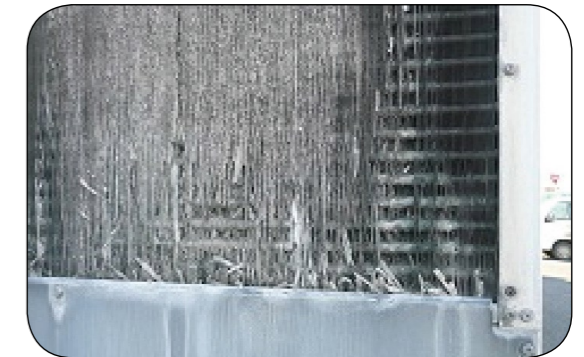
室外機の熱交換器表面の飛散水による腐食
