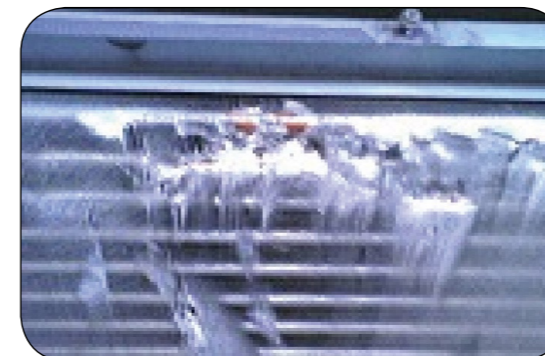
熱交換器表面の損傷
