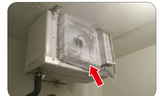
冷却器の内部霜付き異常
