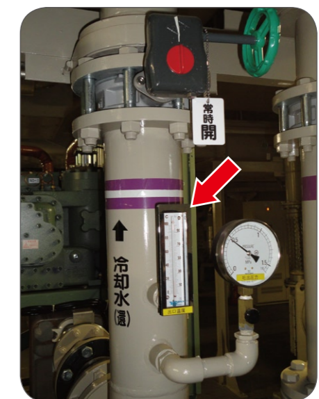
冷却水出口温度計確認
