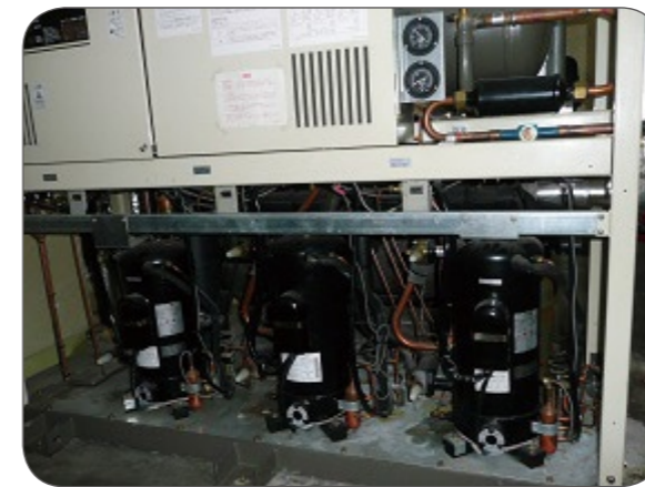
ユニット型冷凍機の異常振動確認
