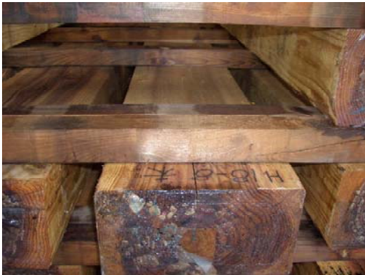
写真10 木口割れの測定
