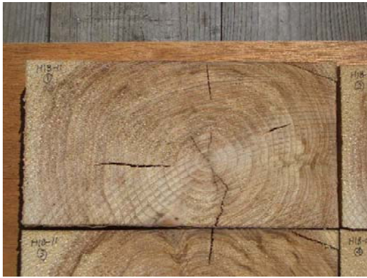
写真 14 内部割れの測定
