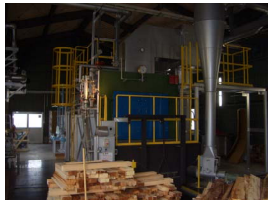
写真10 木屑焚きボイラー本体
