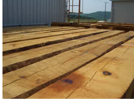
写真 13 材面割れが目立つ
