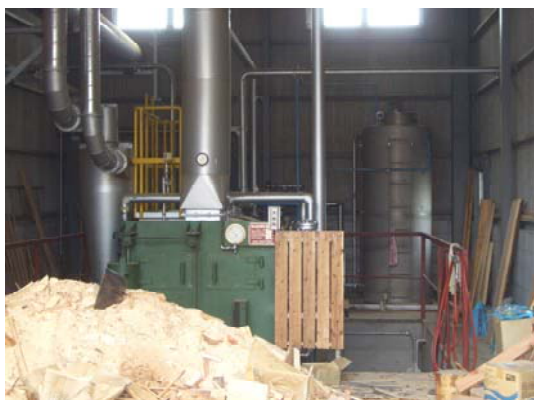
写真1-3 木屑焚きボイラー
