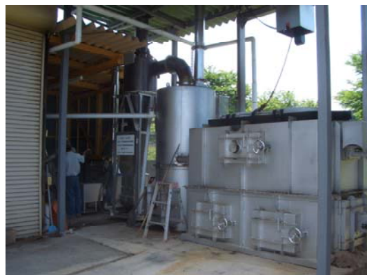
写真7-4 木屑焚き温水ボイラー
