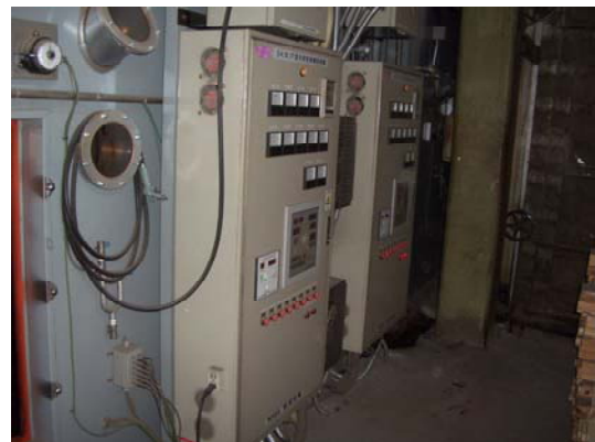
写真2-2 制御盤とセンサー類
