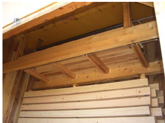
写真7-2乾燥装置の内部
