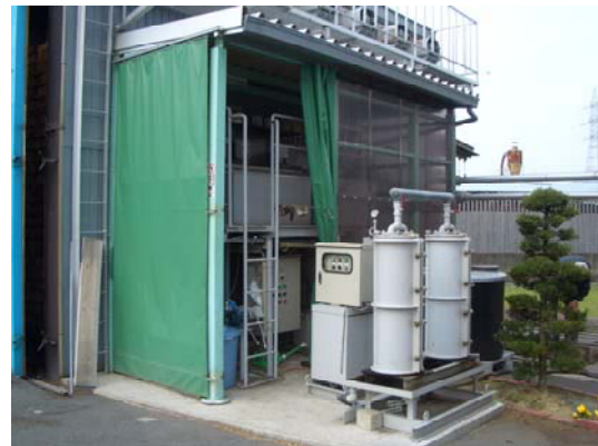
写真3-2 排水処理設備
