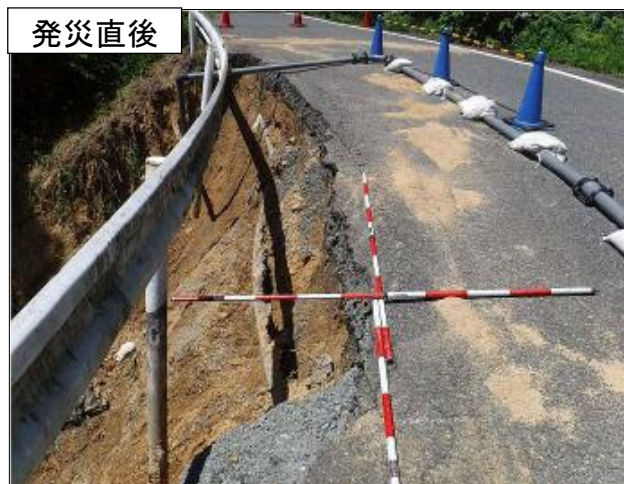
林道の路肩崩落の状況 （岡山市北区建部町）
