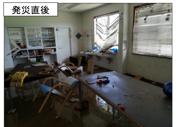
障害者施設の被災状況
