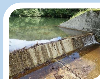
洪水吐のひび割れから漏水している状態
