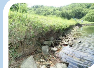
上流法面が侵食されている状態
