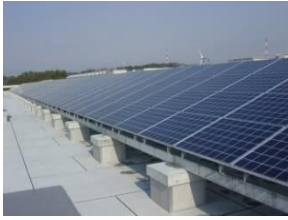
太陽光パネル (50kW)
