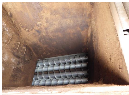
上図：家畜排せつ物受入ホッパーの腐食した部品を交換した様子
