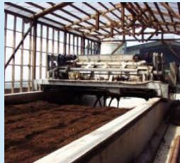
メタンの排出抑制、 良質な堆肥生産に資する 堆肥処理施設
