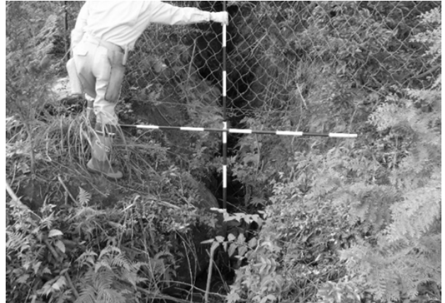
図-19 設置方法不良（水路）
