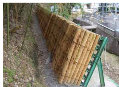
落石防護柵(高梁市)
