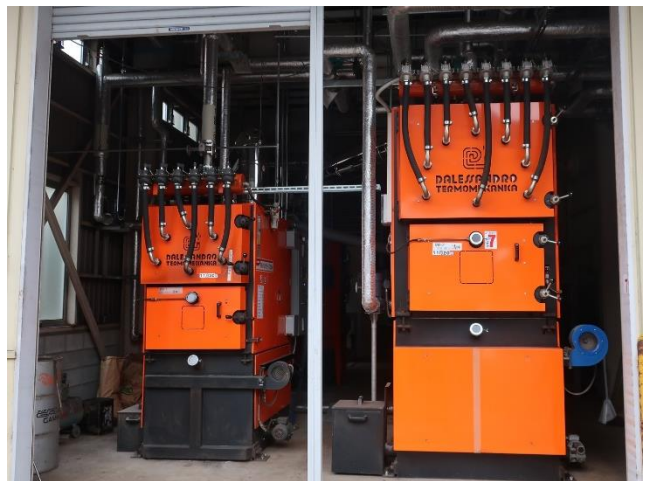
西栗倉村熱エネルギーセンター[チップボイラ] (西栗倉村)
