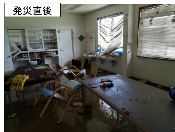
障害者施設の被災状況
