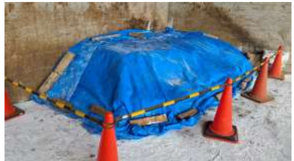
図9 ブルーシートで被覆
