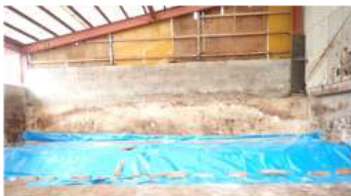
図4 ブルーシートで被覆
