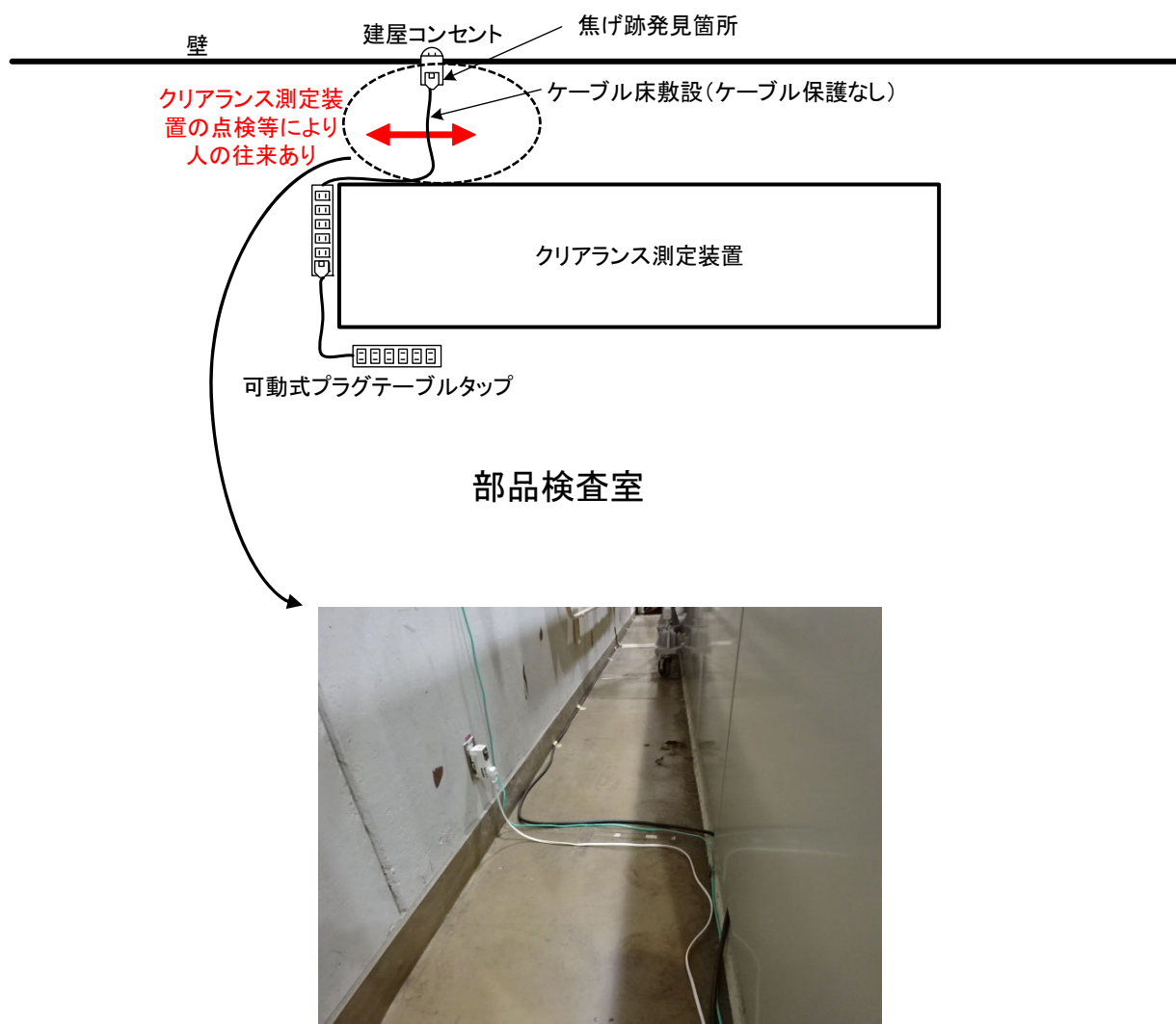
可動式プラグテーブルタップケーブル敷設状態（再現写真）
