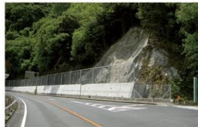
道路災害を防ぐ落石防護柵
