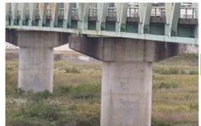
耐震対策がされていない橋脚
