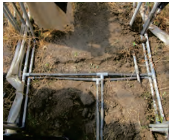
冷却設備の配管
