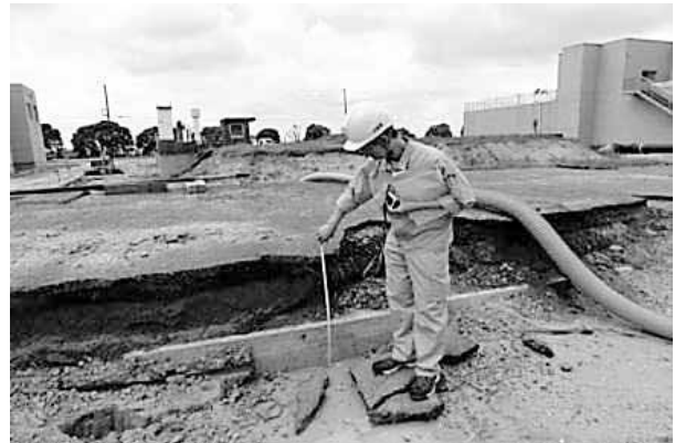
液状化により共同溝の浮き上がりや周辺地盤の沈下（80cmの段差）が発生。
