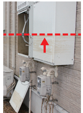
冠水した給湯器
