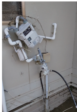
LPガス設備の損傷
