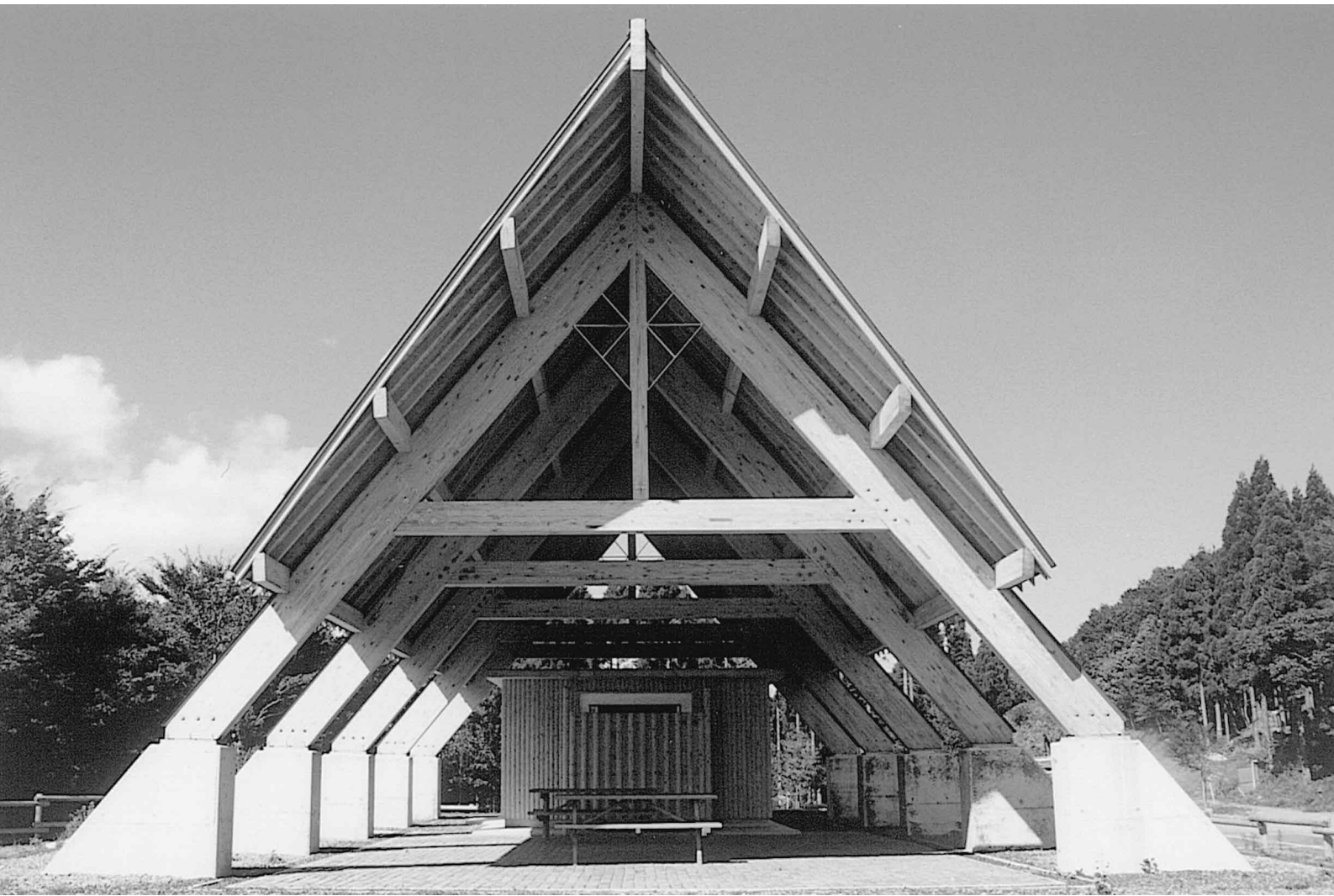
地域の木材利用施設「駒の尾山登山口休憩施設」(西粟倉村)
