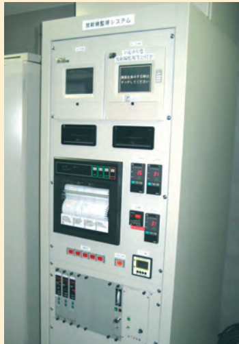
空間ガンマ線測定装置
