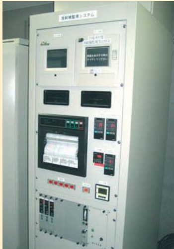
空間ガンマ線測定装置
