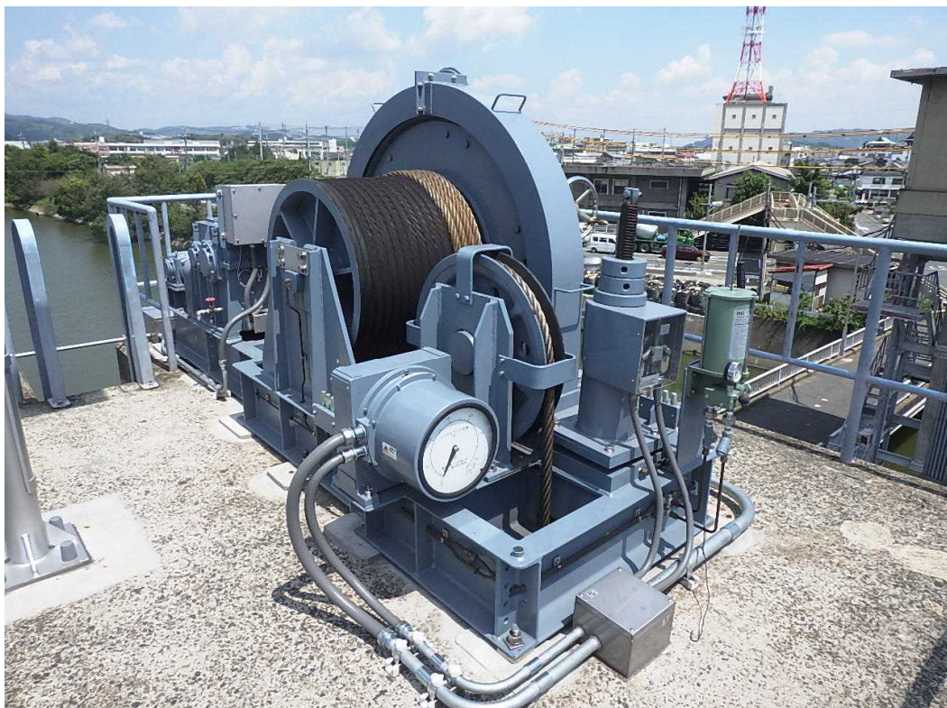
②開閉装置
