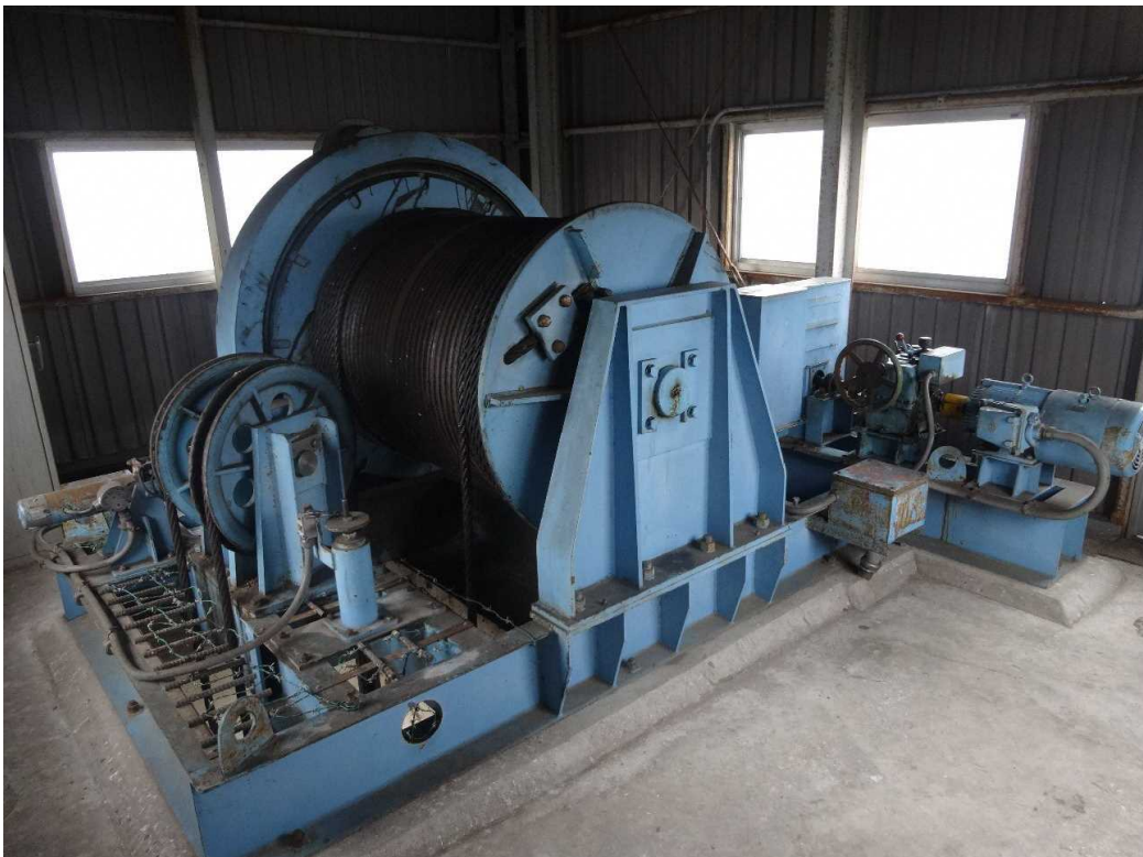
②開閉装置
