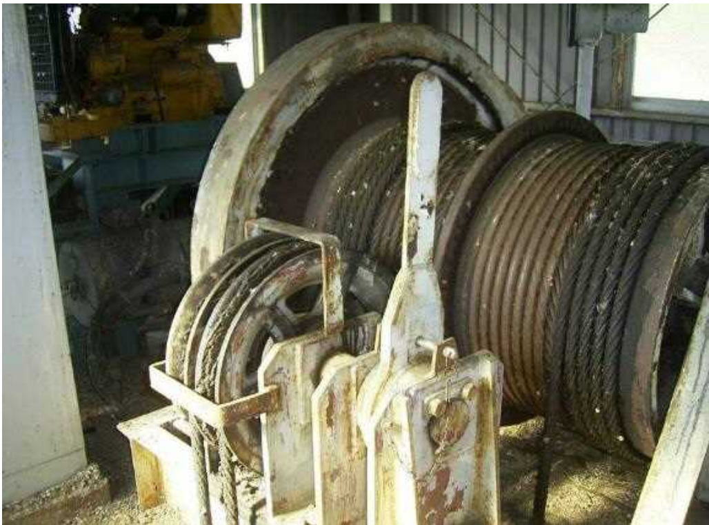
②開閉装置
