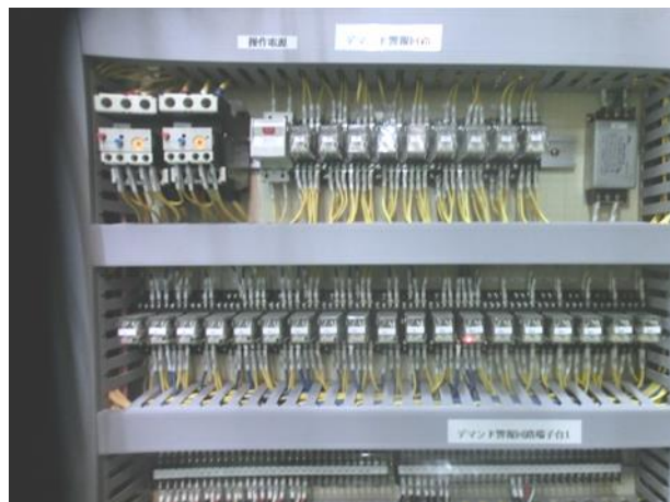
デマンド警報・出力回路
