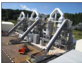
宮城県南三陸処理区仮設焼却炉 (本格稼働開始:H24.12)
