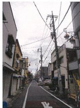
電柱が傾いている。地震時に倒れないか
