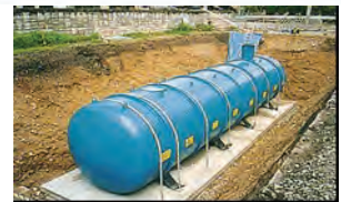
【耐震性貯水槽】
