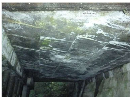
コンクリート床版ひび割れ・遊離石灰
