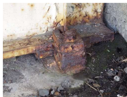
前田橋（支承腐食）
