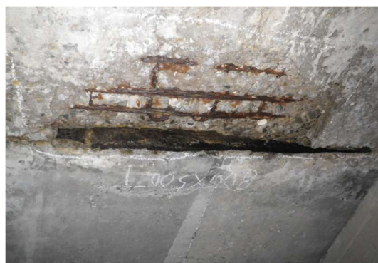
コンクリート床版の鉄筋露出
