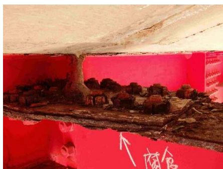
熊山橋（鋼材腐食）
