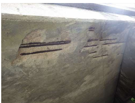
鏡橋（床版鉄筋露出）
