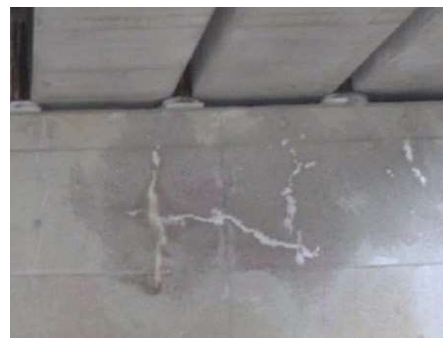
総社橋（下部工ひび割れ）
