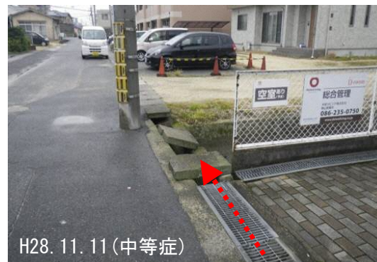
○水路蓋がなくなる箇所
