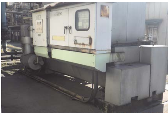
(使用中のターボ冷凍機)
