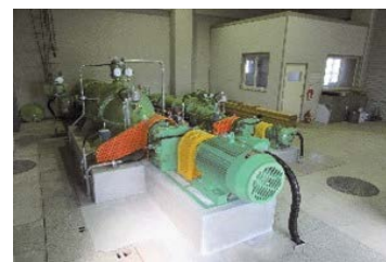
排水機の長寿命化対策
