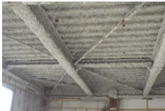
(アスベストが吹き付けられた天井)
