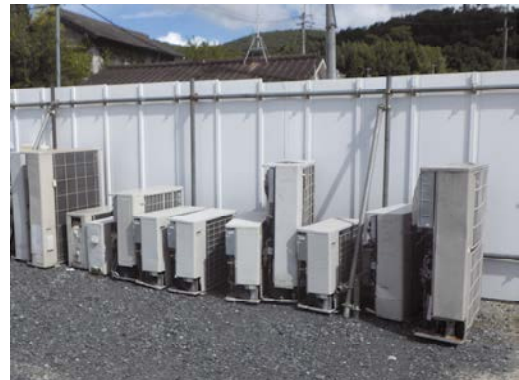
(廃棄される業務用エアコン室外機)
