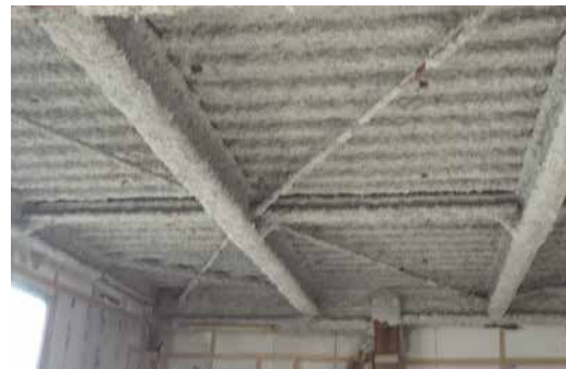
(アスベストが吹き付けられた天井)
