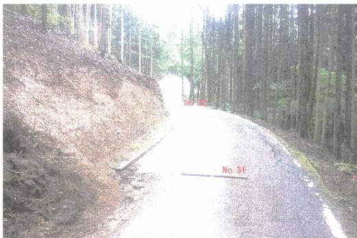
林道法面の改良による走行安全性の確保（改良前）
