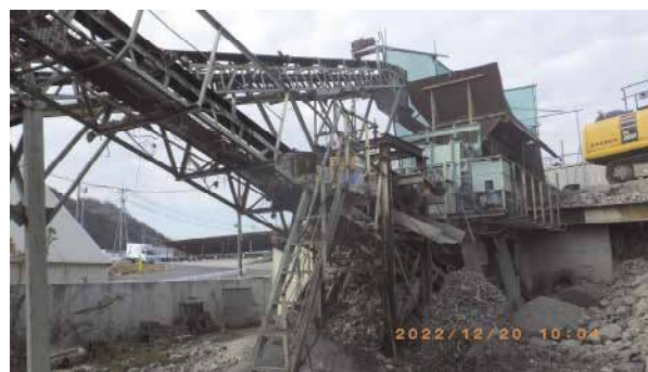
産業廃棄物処理施設（破碎施設）
