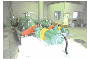
排水機の長寿命化対策
