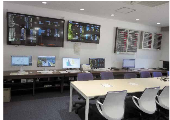
高瀬川ダム（遠隔監視・操作装置更新完了）
