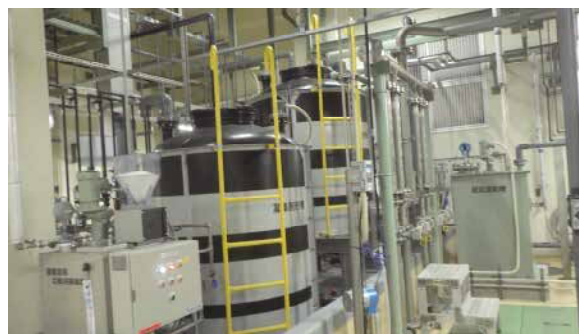
同左（浸出液処理設備）
