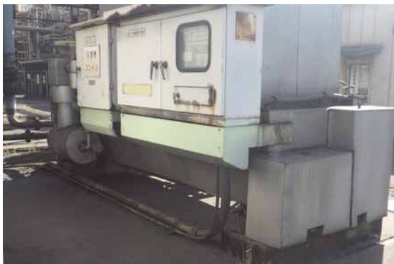
(使用中のターボ冷凍機)
