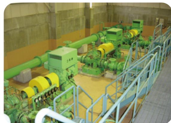
塩生加圧ポンプ場
