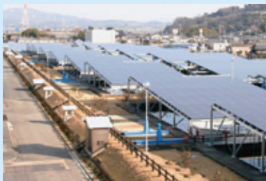
西之浦浄水場太陽光発電システム
