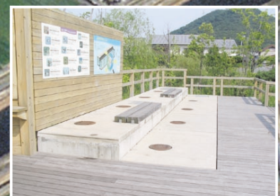
●水質浄化施設
