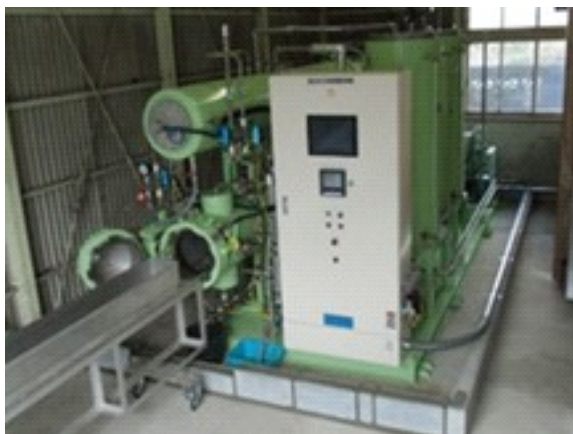
真空・加圧含浸装置
