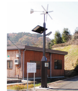
(発光ダイオードを使用した風力・太陽光発電街路灯 中央町)
