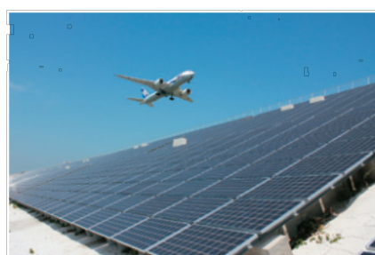
岡山空港太陽光発電所
