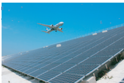
岡山空港太陽光発電所
