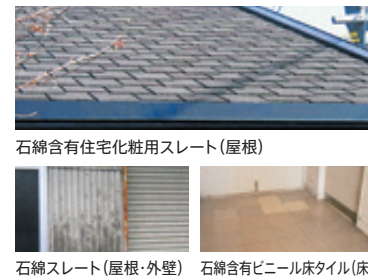
石綿含有住宅化粧用スレート(屋根) 石綿スレート(屋根・外壁) 石綿含有ビニール床タイル(床)
