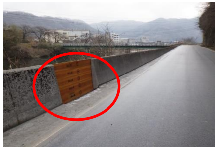
(例) 人のための出入り口の小規模な陸閘
