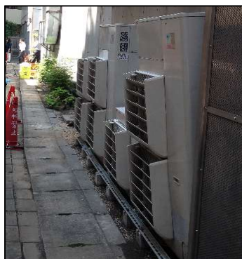
倒れそうな室外機
