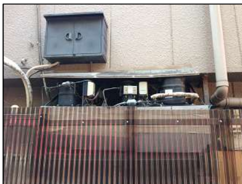
雨ざらしの室外機
