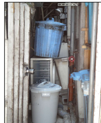
吹き出し口が塞がった室外機
