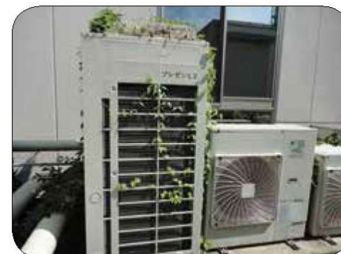
草で覆われた室外機
