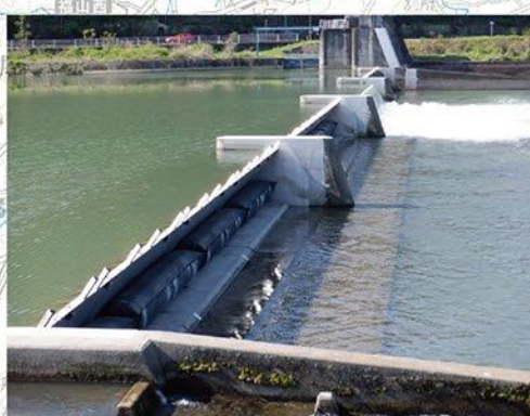
農業用河川工作物応急対策事業（笠ヶ瀬地区）
