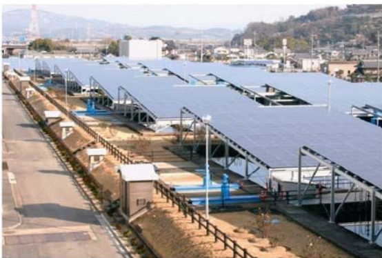
西之浦浄水場太陽光発電システム
