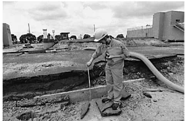
液状化により共同溝の浮き上がりと周辺地盤の沈下（80cmの段差）が発生。
