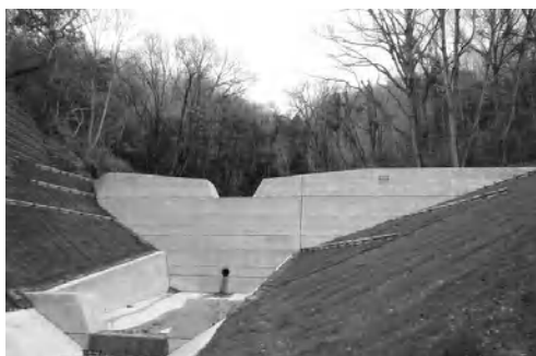
地域の安全を守る谷止工
